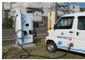
充電設備の設置（西南社の湖畔公園）
