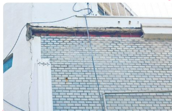
軒・ひさしの剥離・落下
