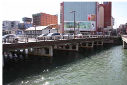
⑧橋の老朽化（中洲新橋）
