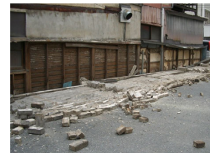
ブロック塀の倒壊
