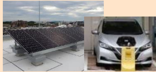
市営住宅における脱炭素の取組み (太陽光発電設備、EVカーシェアの施行実施など)
