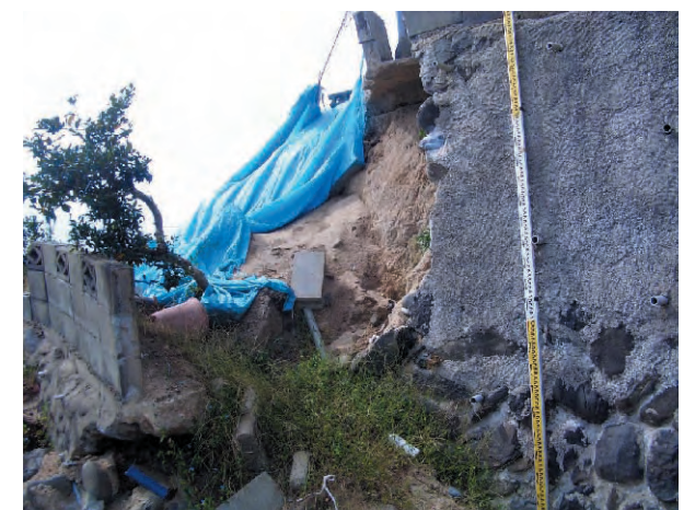
被災宅地調査
