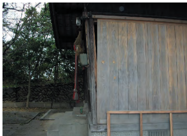
傾いて隙間が空いた拝殿
