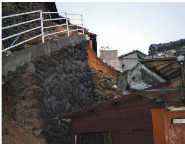
擁壁とともに崩落した道路
