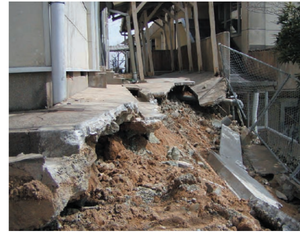
基礎が崩落した小学校校舎
