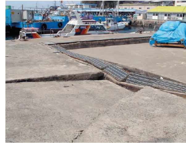
段差が生じた岸壁
