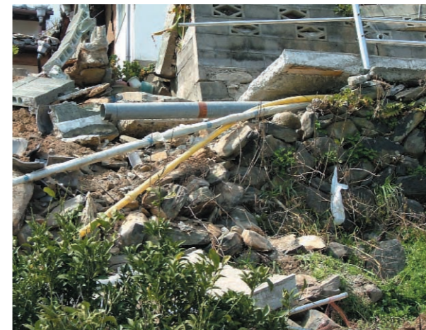
ライフラインの破損
