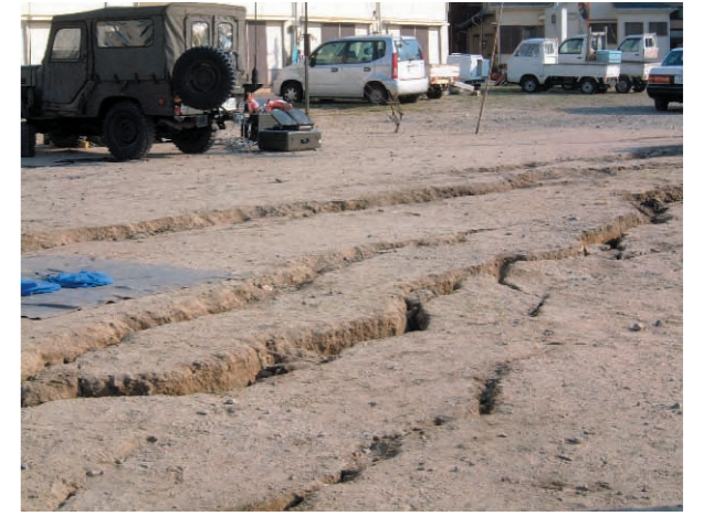
地割れが生じた漁港施設
