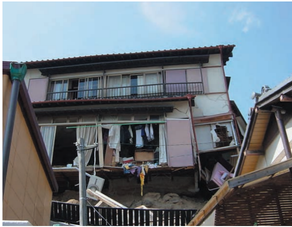
宅盤擁壁が崩落した家屋
