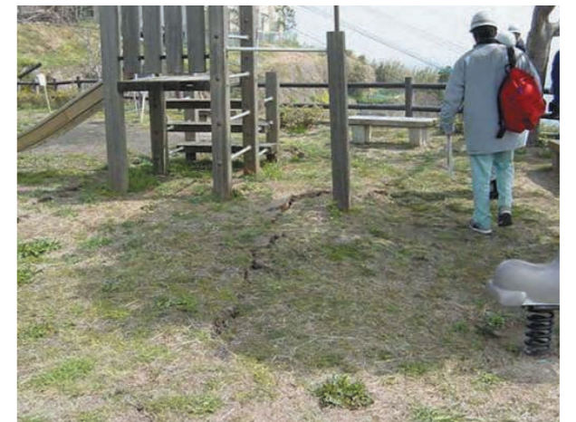
地割れが生じた公園
