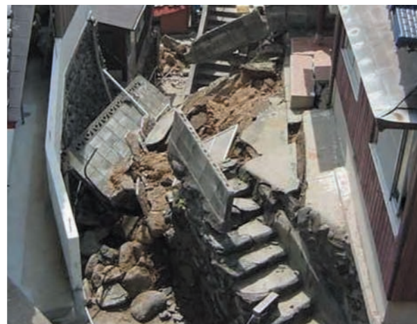
破断された道路
