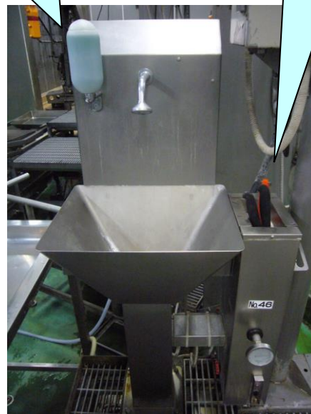
↑と畜解現場の洗浄消毒設備
