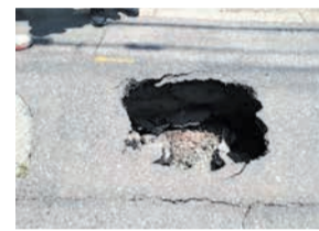
道路の破損、くぼみ、穴
