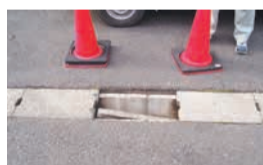
側溝・側溝蓋の破損
