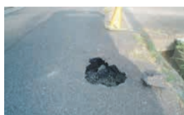
舗装の破損、くぼみ、穴
