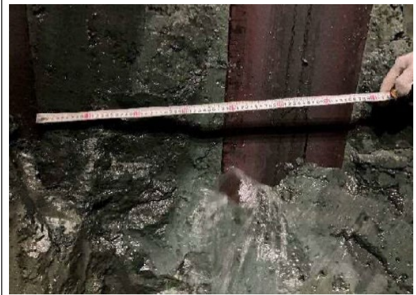
地下水の湧出（発進立坑）
