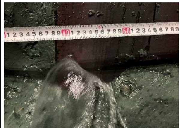
地下水の湧出（発進立坑）
