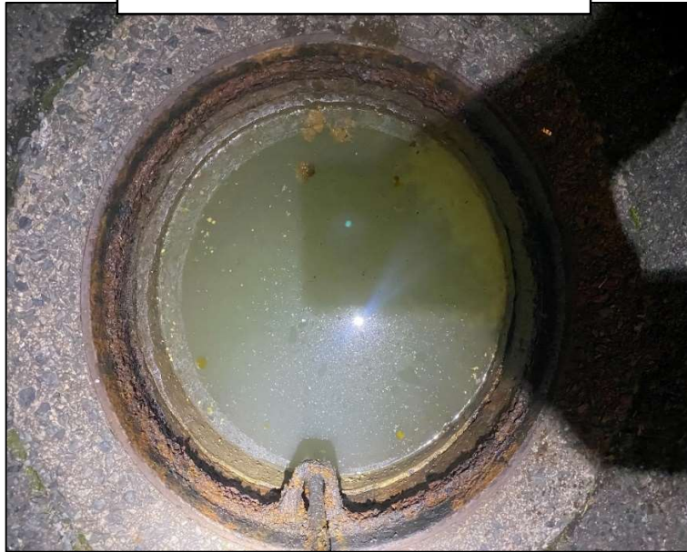
トイレ被災直後状況（遠景）
