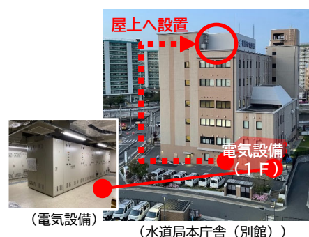
水道局本庁舎の電源喪失対策
