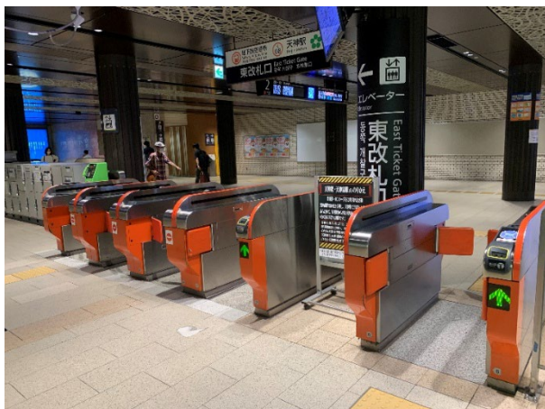
空港線改札機（平成 21 年導入）
