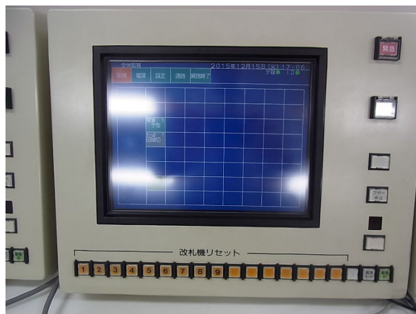
七隈線駅務監視装置※（平成 17 年導入）
