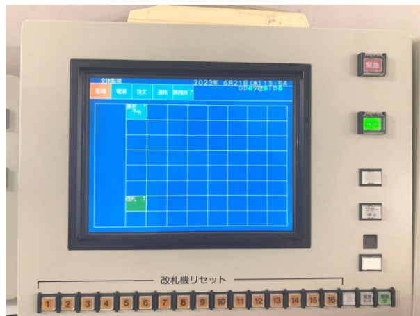
空港線駅務監視装置※（平成 21 年導入）
