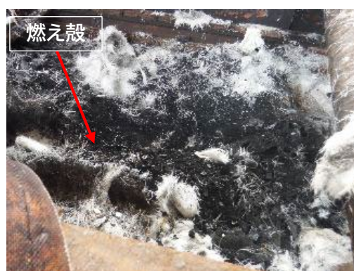
コンベア内部状況（拡大）
