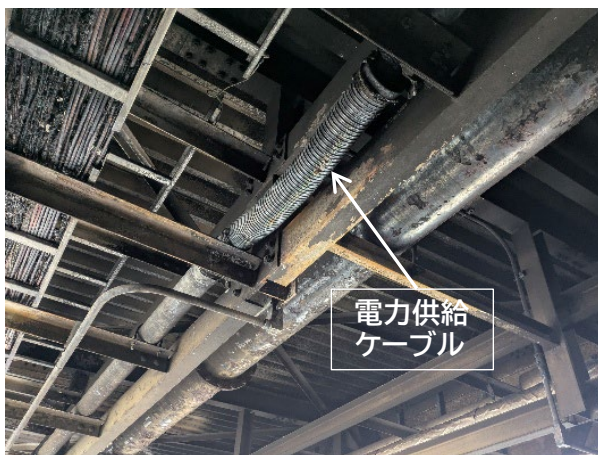
電力供給ケーブル等の焼損状況
