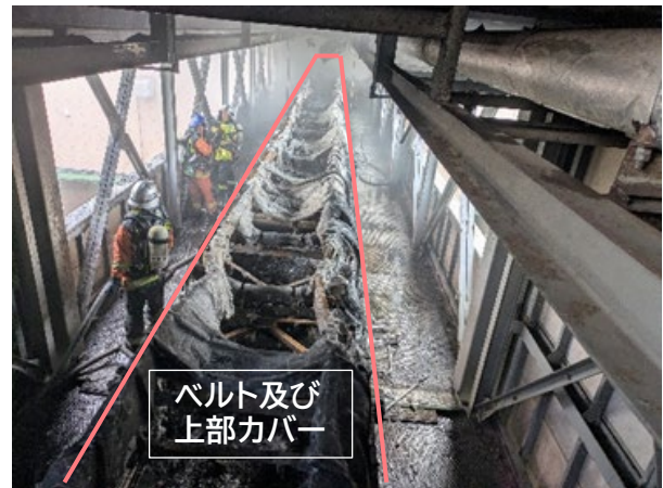
可燃物搬出コンベアの焼損状況
