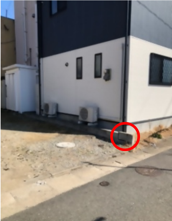
事故現場写真
