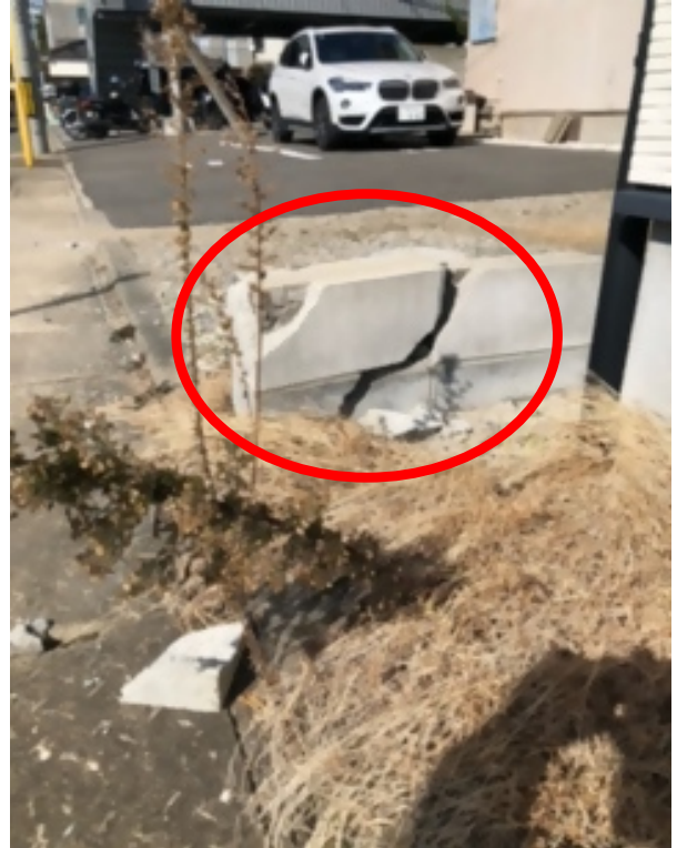
相手方施設設備損傷写真
