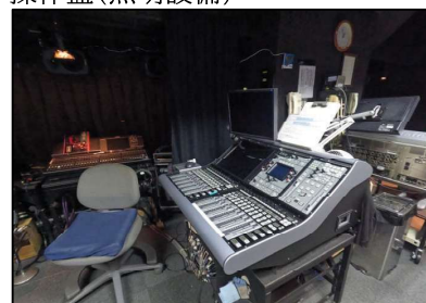
操作盤(照明設備)
