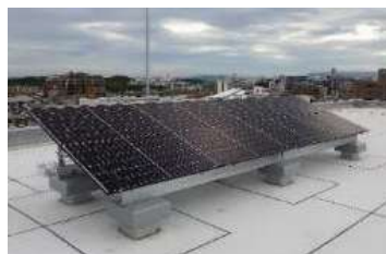
市営住宅に適した脱炭素の取組みの検討(太陽光発電設備の試行設置)
