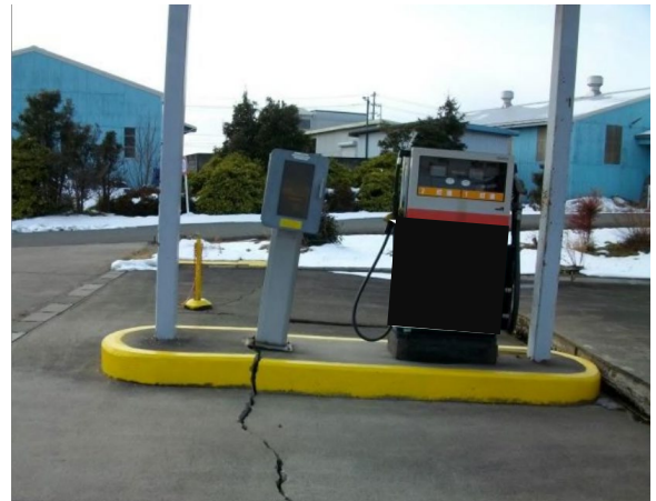
(地震で被災したガソリンスタンド)
