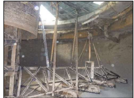
老朽化した設備（重力濃縮槽汚泥掻寄機）
