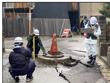
令和6年能登半島地震の被害（金沢市）
