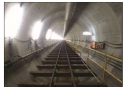
雨水管（内径約5m）
