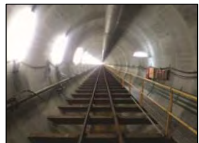
雨水管（内径約 5m）
