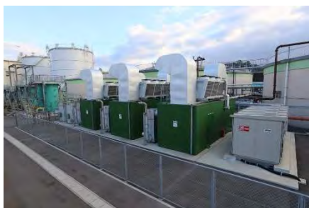
▲下水バイオガス発電機
