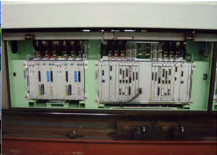
自動列車制御装置（ATC）
