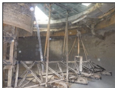
老朽化した設備（重力濃縮槽攪拌機）
