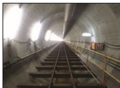
雨水管（内径約5m）
