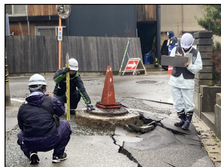
令和6年能登半島地震の被害（金沢市）
