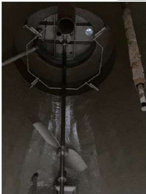
消化槽攪拌機
