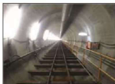
雨水管（内径約5m）
