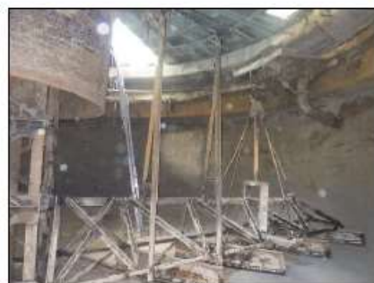
老朽化した設備（重力濃縮槽攪拌機）
