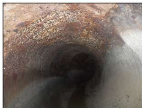
老朽化した下水道管内の状況 （鉄筋・骨材の露出）
