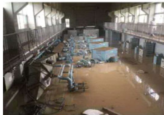
浸水被害を受けたポンプ施設
