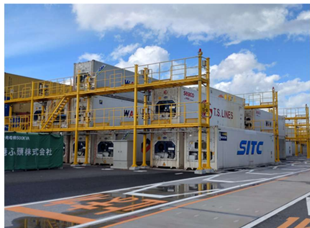
■冷凍コンテナ専用電源
