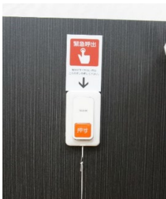
トイレ内スイッチ
