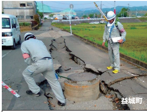
熊本地震管渠被災状況（平成28年4月）
