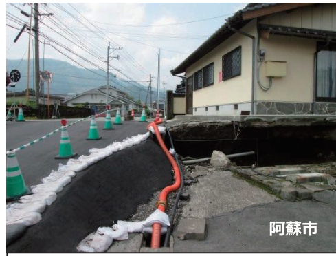
熊本地震断層沈下状況（平成28年4月）
