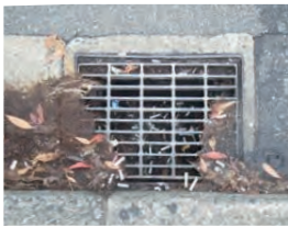
側溝のつまり 砂やごみが溜まっている。
