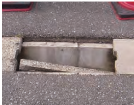
道路や側溝蓋の破損 道路がくぼんでいる。 蓋が割れている。
