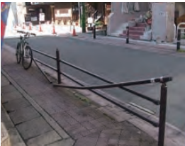
防護柵の破損 ガードパイプが曲がったり、 折れたりしている。
