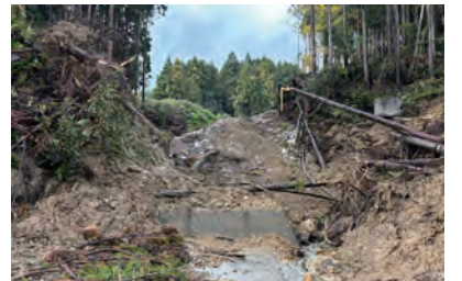
▲派遣当初の被災状況
