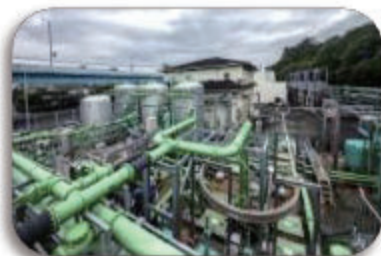
再生水処理施設
