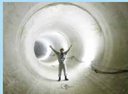
天神地区の大きな雨水管
