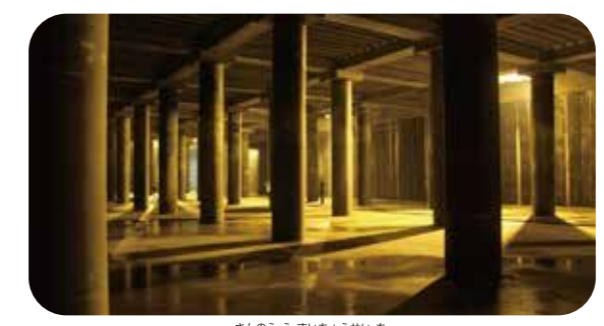
山王雨水調整池
