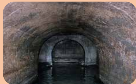
古くなった下水道管
