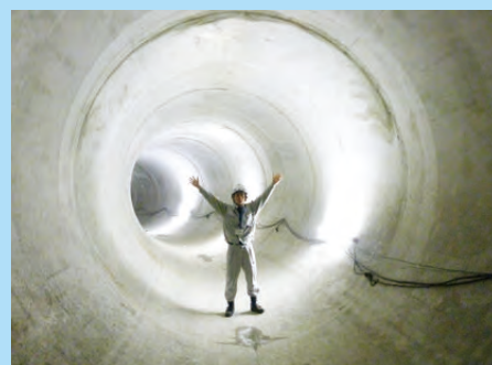
天神地区の大きな雨水管
