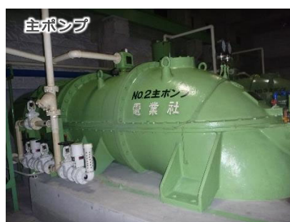
（二級河川吉塚新川排水機場）
