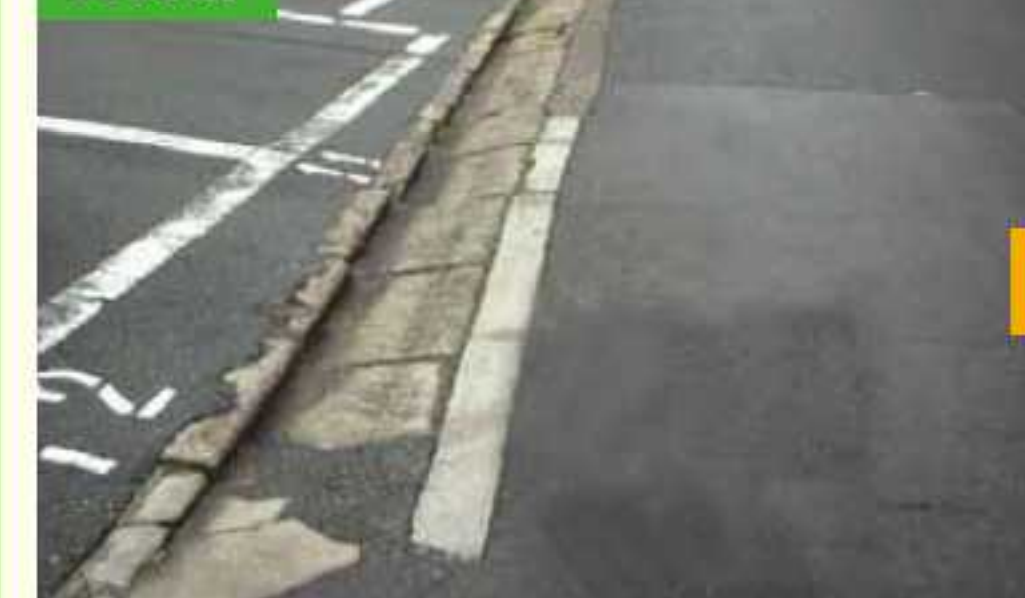
老朽化した道路
