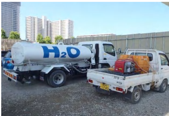
写真②-1 施工ヤードの散水設備
