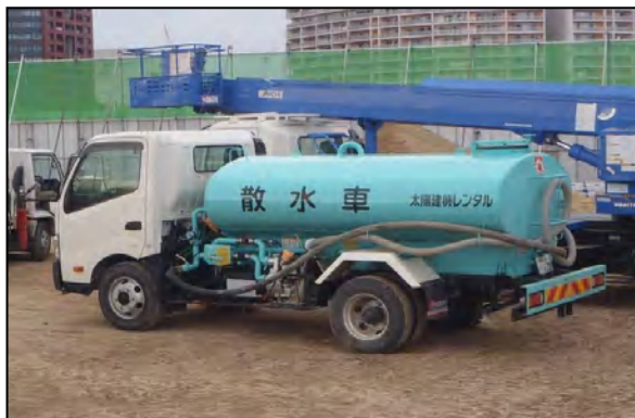
写真③-1 施工ヤードへの散水設備
