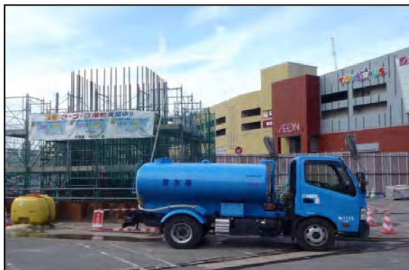
写真①- 1 施工ヤードへの散水設備
