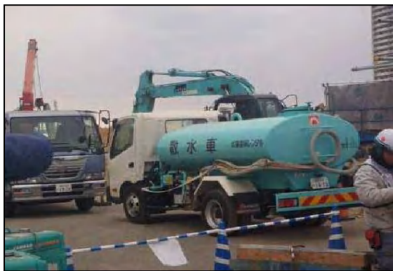
写真③- 1 施工ヤードへの散水設備
