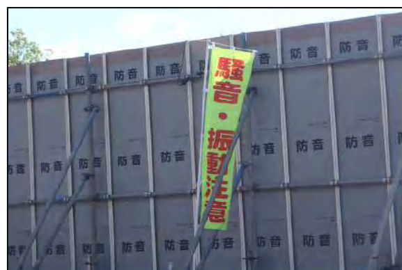
写真①- 4 防音パネル等の遮音対策
