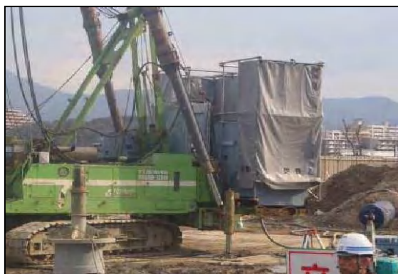
写真②- 3 発電機の防音シート
