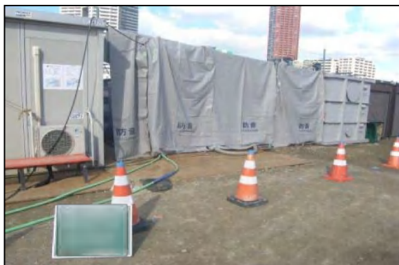
写真①- 3 防音シート等の遮音対策
