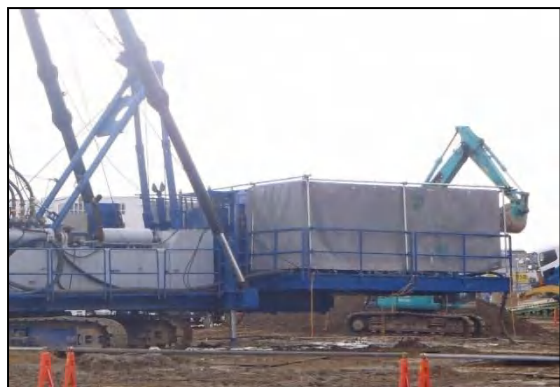
写真③- 3 発電機の防音シート
