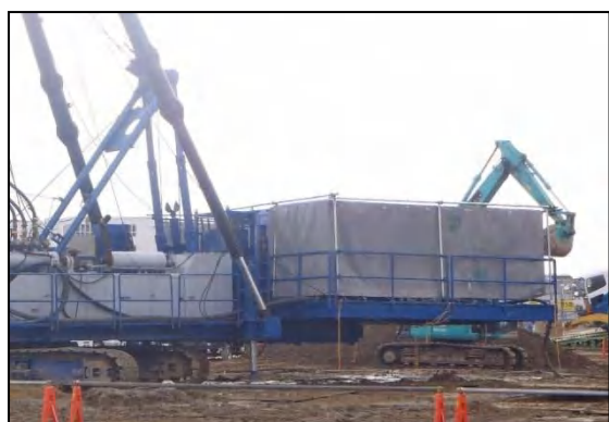
写真③-3 発電機の防音シート
