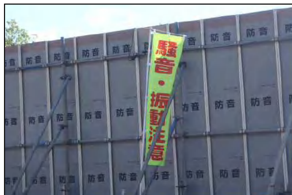
写真①- 4 防音パネル等の遮音対策
