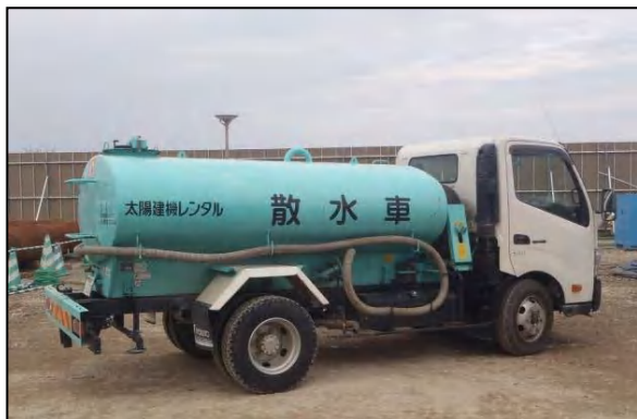
写真②- 1 施工ヤードへの散水設備
