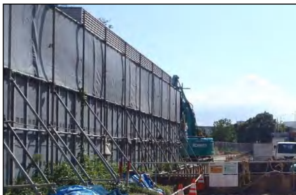
写真①- 3 防音パネル等の遮音対策
