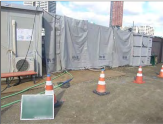
写真①-3 防音パネル等の遮音対策
