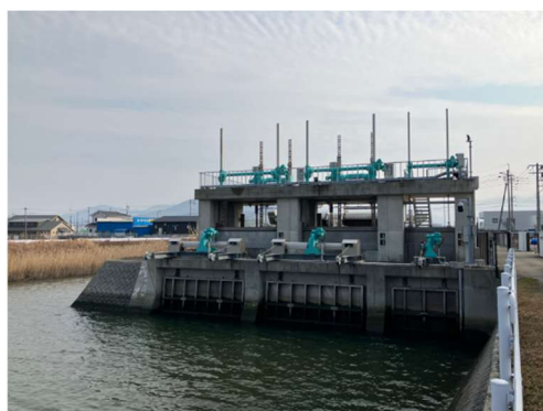
田尻川排水機場
