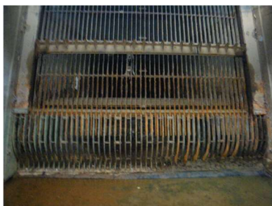
更新前 （排水機除塵機スクリーン）
