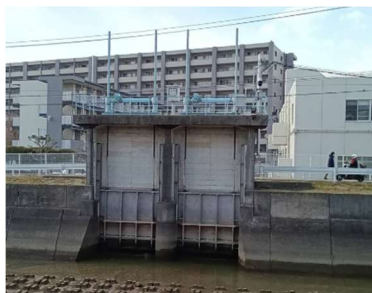
排水機場 ゲート遠景
