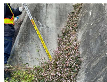
護岸クラック
