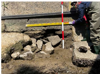
護岸基礎部破損
