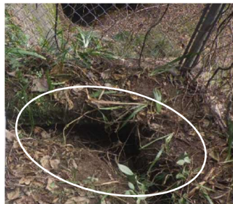
護岸背後の沈下
