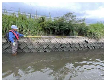
護岸はらみ・欠損
