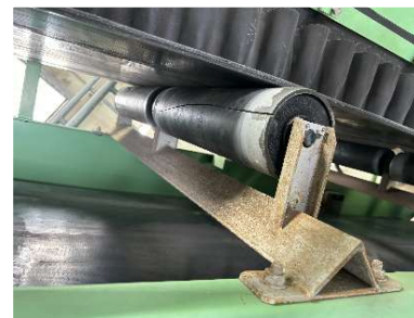
排水機場 除塵機コンベア損傷
