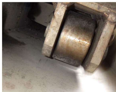
排水機場 ゲートルーラー固着・錆
