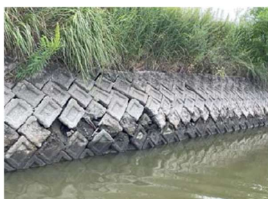
更新前 （護岸のはらみ・欠損）
