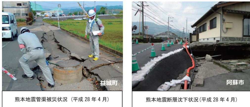
図 2.2.4 熊本地震による被害状況
