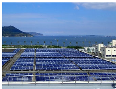
▲水処理センターの太陽光発電
