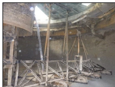
老朽化した設備（重力濃縮槽汚泥掻寄機）
