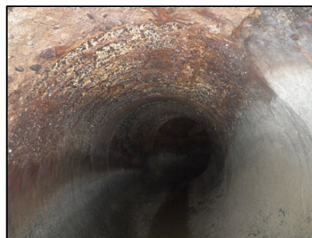
老朽化した下水道管内の状況 （鉄筋・骨材の露出）
