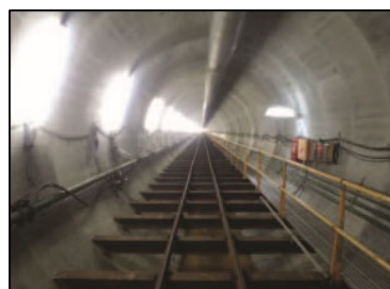
雨水管（内径約 5m）
