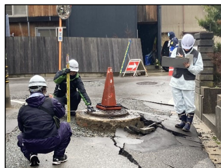
令和6年能登半島地震の被害（金沢市）
