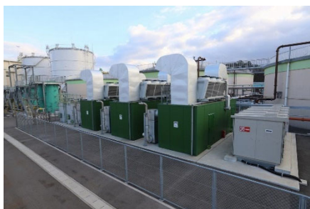
▲下水バイオガス発電機
