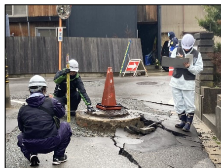
令和6年能登半島地震の被害（金沢市）
