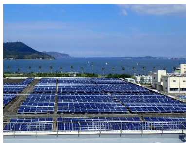
▲水処理センターの太陽光発電
