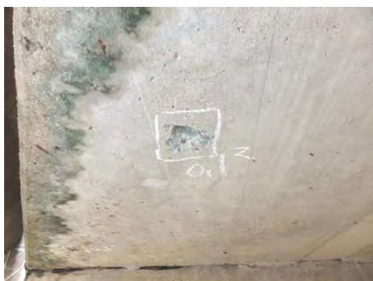
床版端部（水の回り込み）
