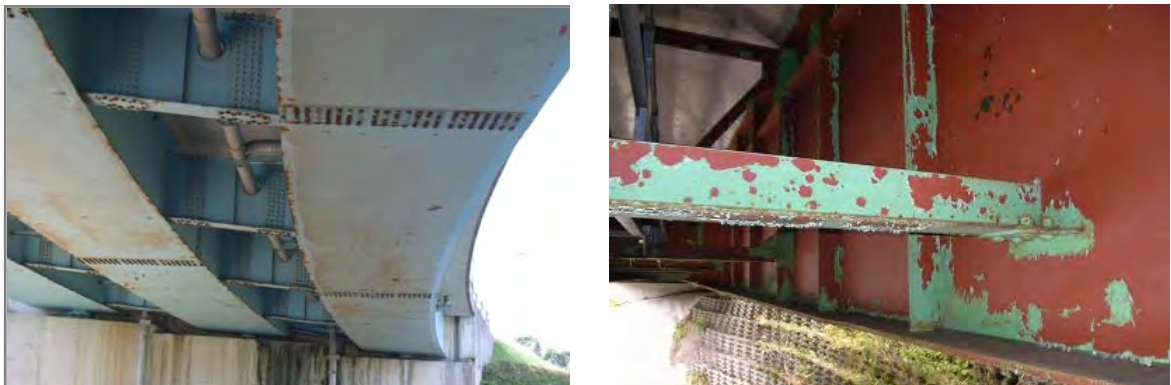
写真 4-1 塗装劣化の事例
