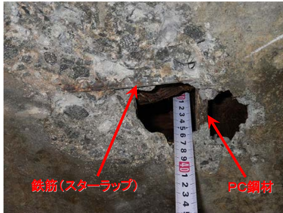
写真 4-1-2 ホロー形式の初期欠陥事例 【コンクリートの充填不足（はつり後）】
