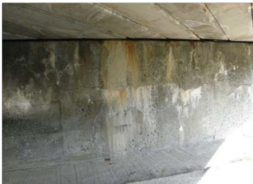
写真 3-3-4 ASRによるアルカリシリカゲル滲出例【橋台】
