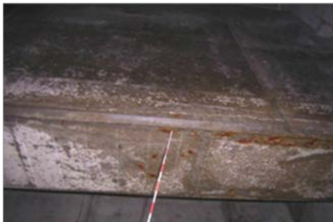
平成 20 年定期点検（うき、判定 b）
