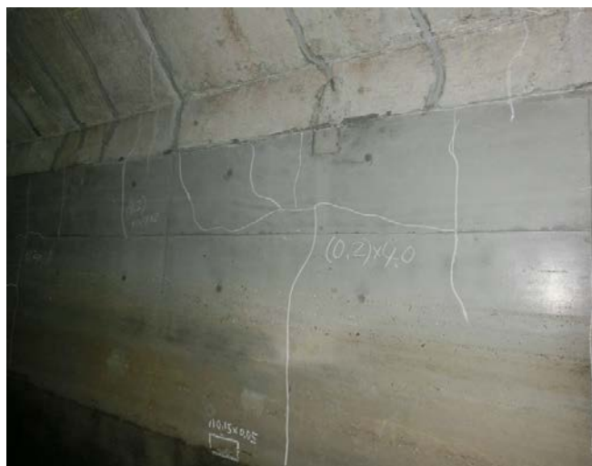
図 4-2-3 断面修復工（モルタル注入工法）の収縮ひび割れによる再劣化【事例】
