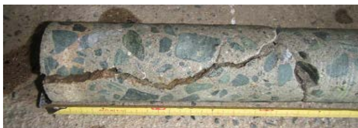
写真 3-3-7 ASR 橋台のひび割れ部コア採取
