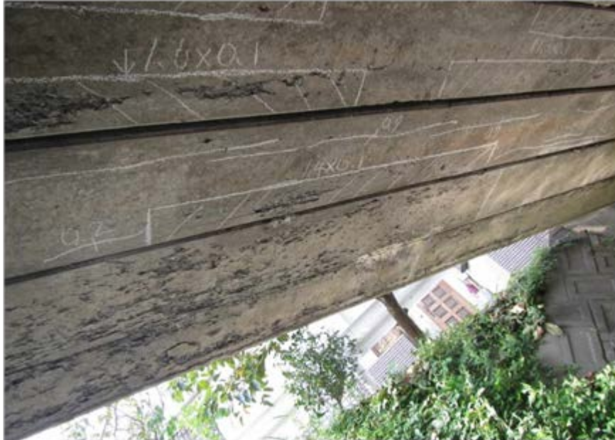
写真 3-3-3 ASRによる表面劣化例【PCプレテンI桁橋】
