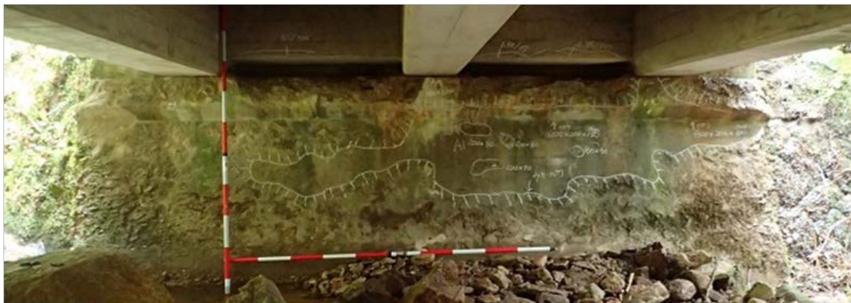
写真 3-4-2 南向き橋台正面（スケーリング）
