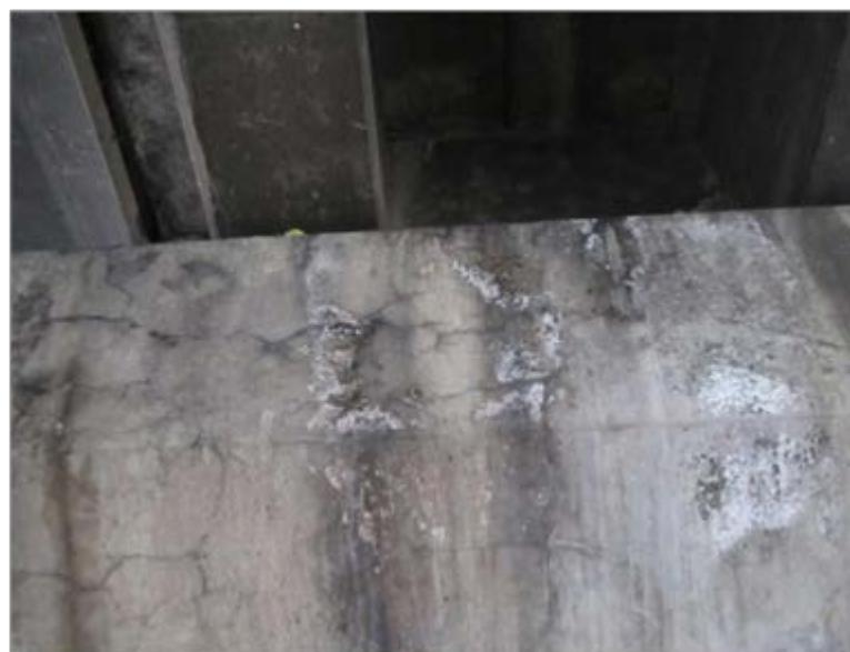
写真 3-3-2 ASRによる亀甲状のひび割れ例【橋台】
