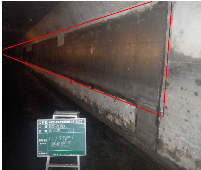
写真 3-1-11 干満の影響を受けた劣化事例<その5>【BOX側壁(断面修復後)】
