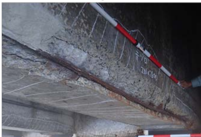
平成 27 年詳細調査（鉄筋露出、判定 d）
