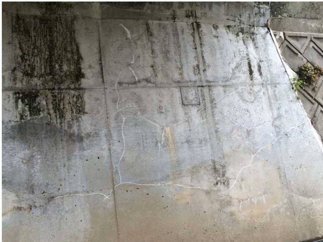
写真 3-3-17 ASR 橋台のコンクリートによる全面打替え後の再劣化例（施工後 3 年弱）
