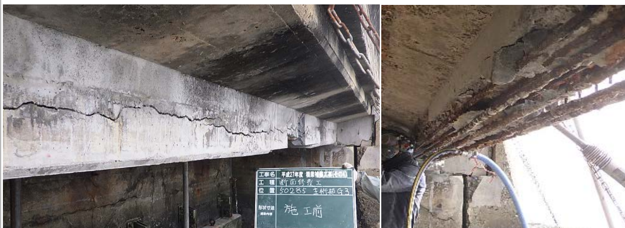
写真 4-2-2 断面修復工（モルタル注入工法）の付着不足による再劣化【事例】
