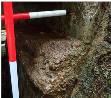
写真 3-4-4 南向き橋台（橋座減少）
