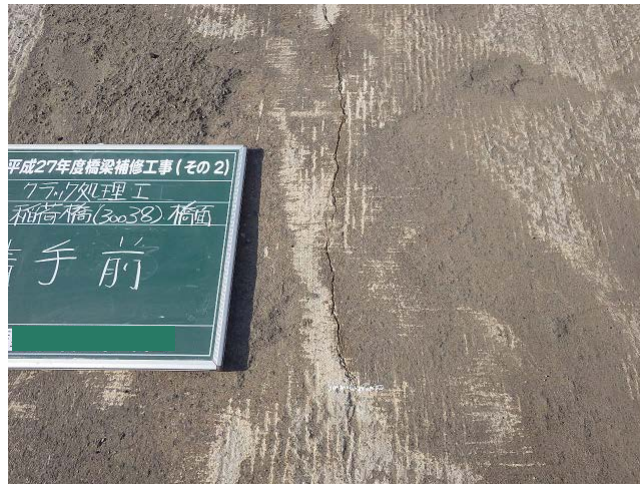
写真 3-3-14 桁の上面のひび割れ例 (PCポステン中空床版橋)
