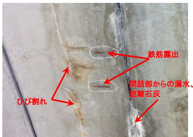
写真 4-1-1 ホロー形式の劣化事例（桁下面）
