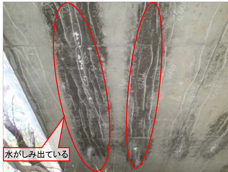
写真 3-3-5 桁下面の状況（ひび割れ、遊離石灰、水の浸透） 【PCボステン中空床版橋】
