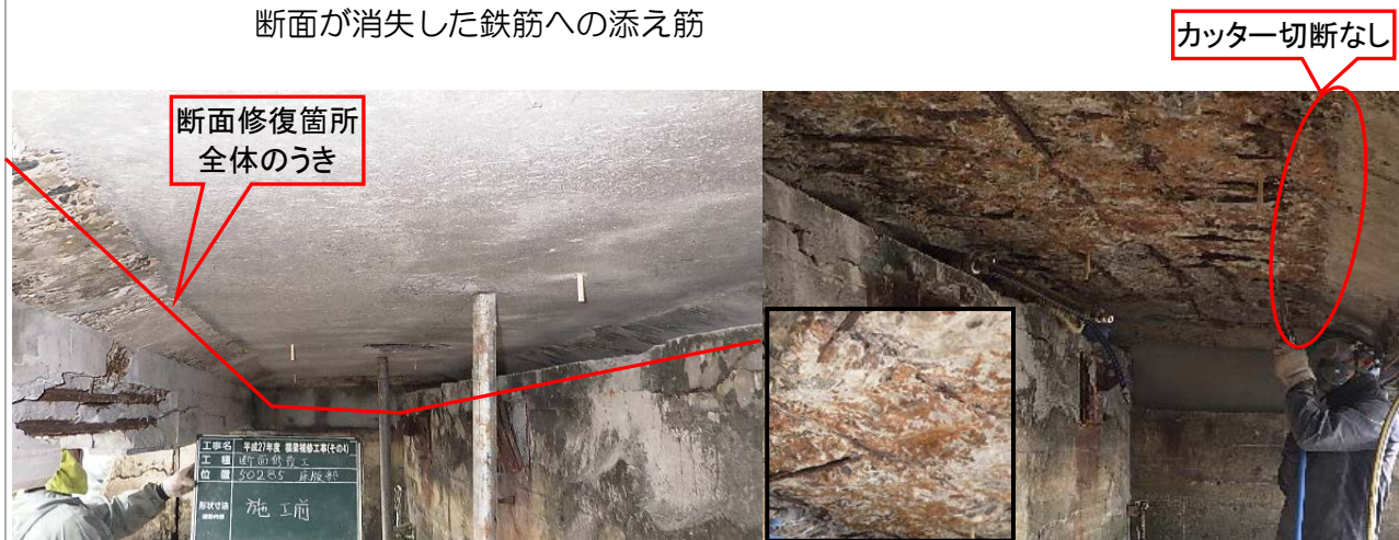
写真 4-2-1 断面修復工（左官工法）の付着不足による再劣化【事例 2】
