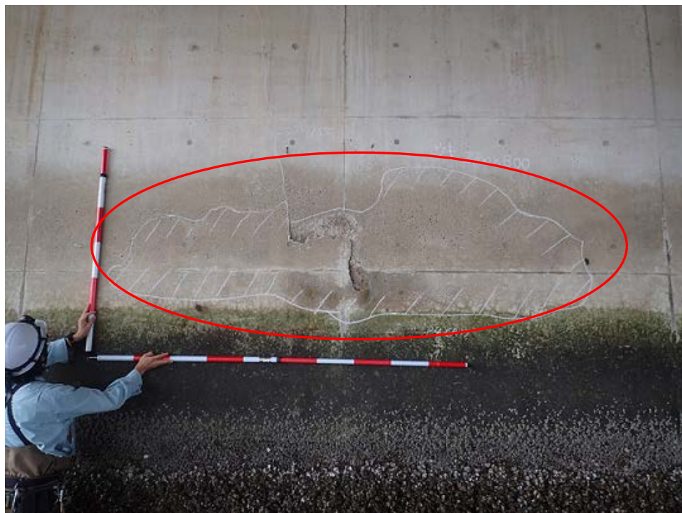
写真 3-1-8 干満の影響を受けた劣化事例＜その 2＞【壁式橋脚(うき)】
