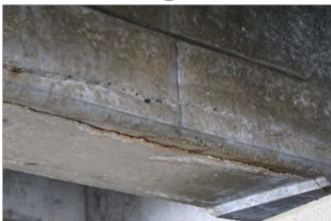
平成 24 年定期点検（うき、判定 c）
