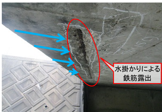
写真 3-1-3 端部からの水掛かり例
