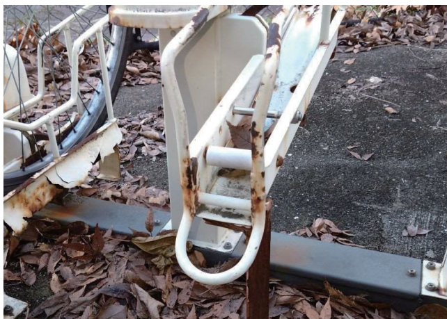
老朽化した駐輪ラック
