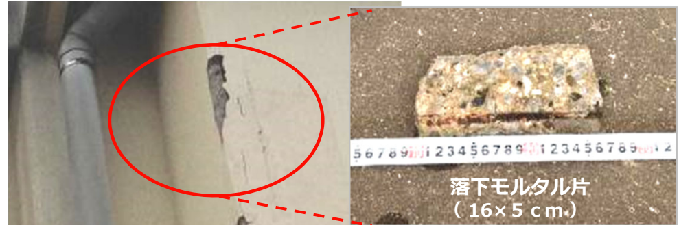
剥離落下が発生した校舎外壁
