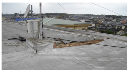
屋上防水シートの破損
