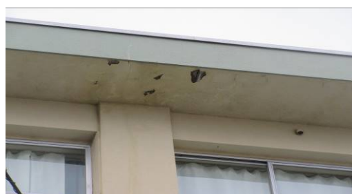
外壁の剥離落下
