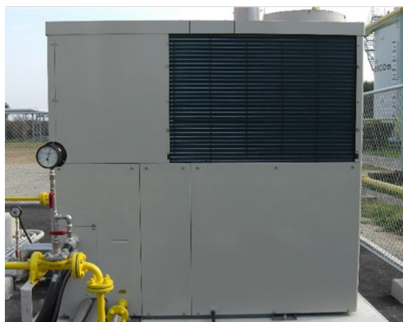
和白水処理センター 下水バイオガス発電
