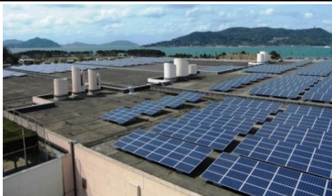
西部水処理センター 太陽光発電
