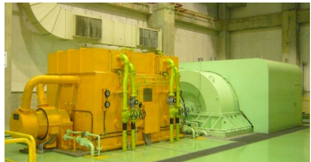
臨海工場 蒸気タービン発電機
