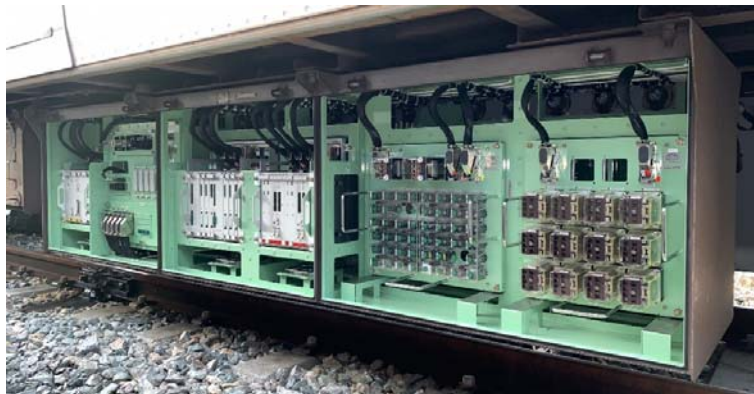
自動列車制御装置
