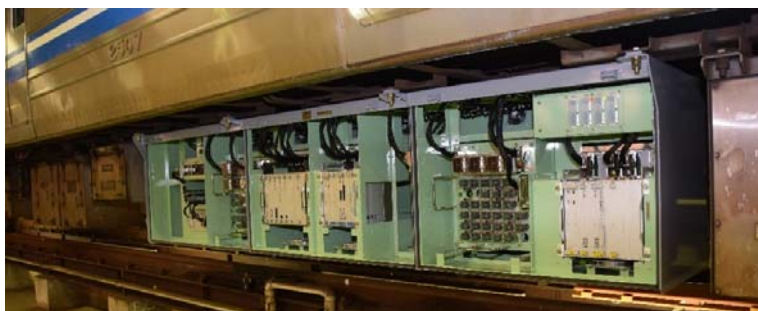
自動列車運転装置
